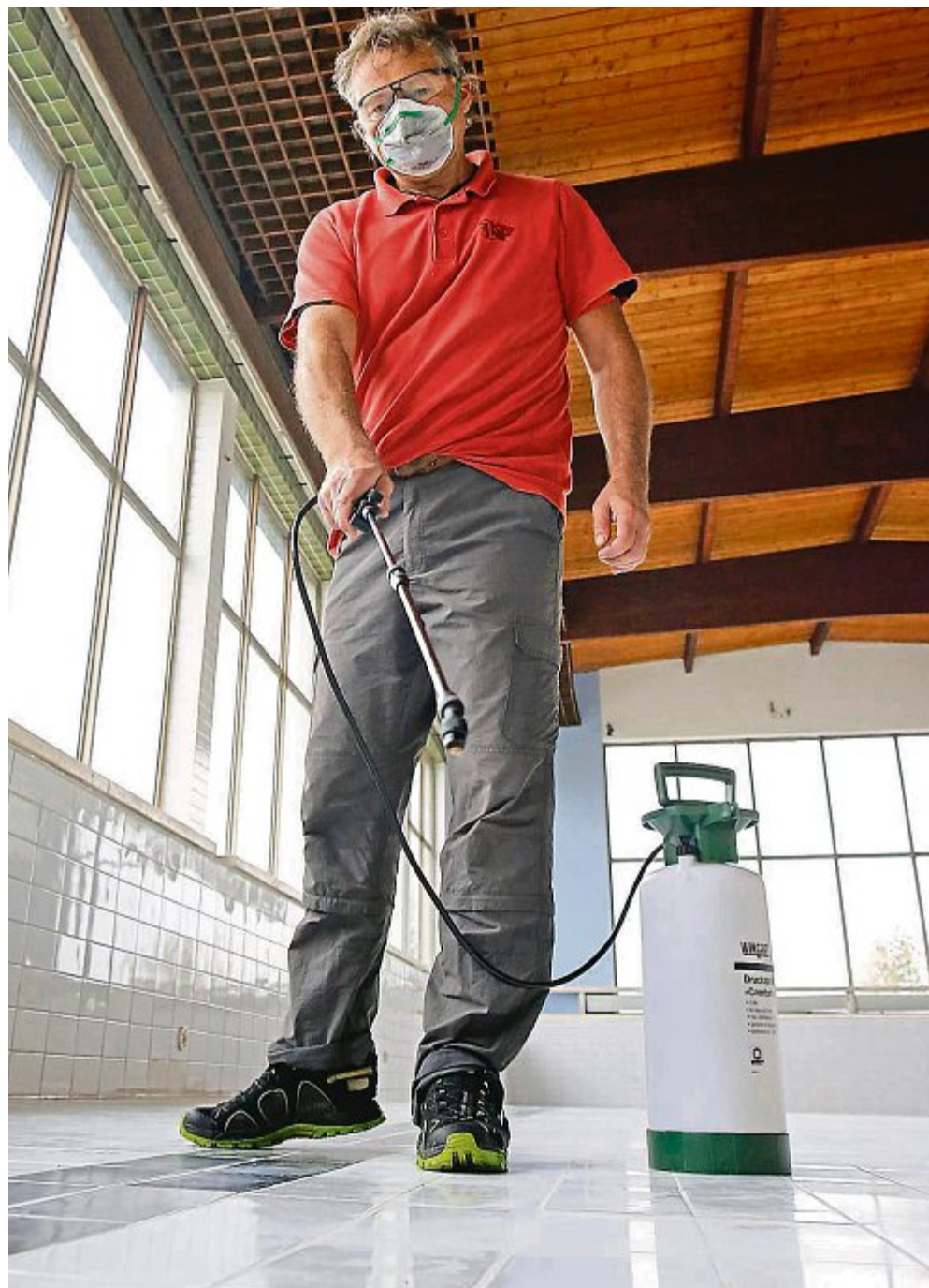
Nicht nur sauber, sondern rein: Bevor das Hallenbadbecken wieder mit Wasser gefüllt wird, versiegelt Bademeister Christian Siegert den Beckenboden. So können sich keine Algen bilden, erklärt der Greilinger.
