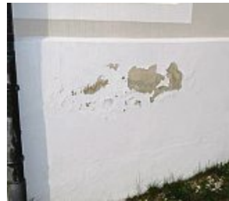
Das Mauerwerk an der Kirche ist schadhaft. FOTO: XB
